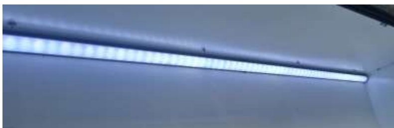
Eclairage par ruban à leds de l'intérieur des coffres
